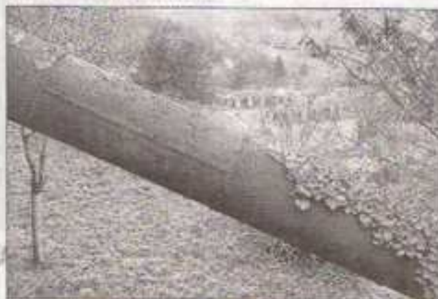
La conduite forcée qui circule dans le village paraît vétuste
